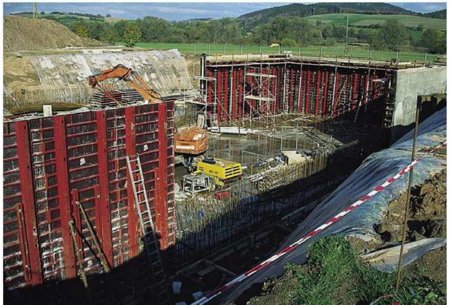
Kläranlage Rothenburg a. d. F.; Fa. Steube, Rothenburg a. d. F.
