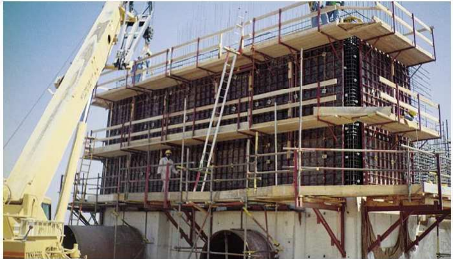
Naturgas-Verflüssigungsanlage, OM-Oman; Fa. Bahwan Engineering, OM-Oman
