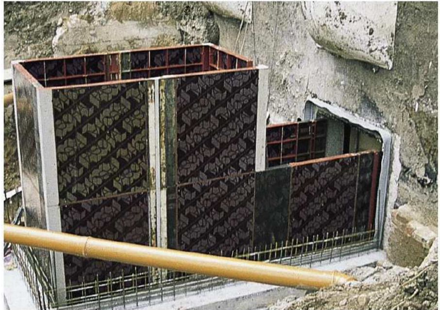
LVA, Belüftungsschacht; Fa. Gomoll, Harheim
